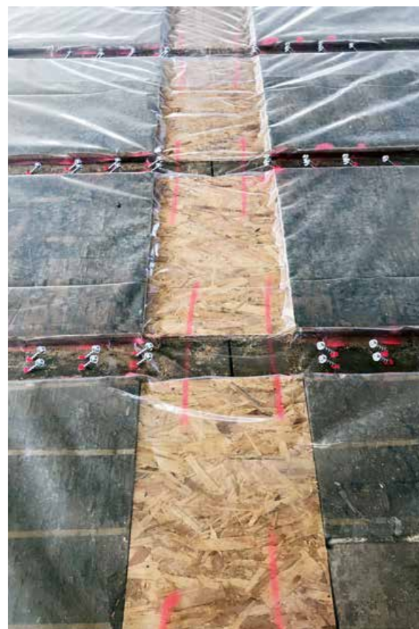
► Die Folie dient als Trenn- und Schutzschicht des Frischbetons zur Holzkonstruktion. Die Lage der Schubverbinder wurde im Vorfeld statisch berechnet und auf der Folie exakt gekennzeichnet
