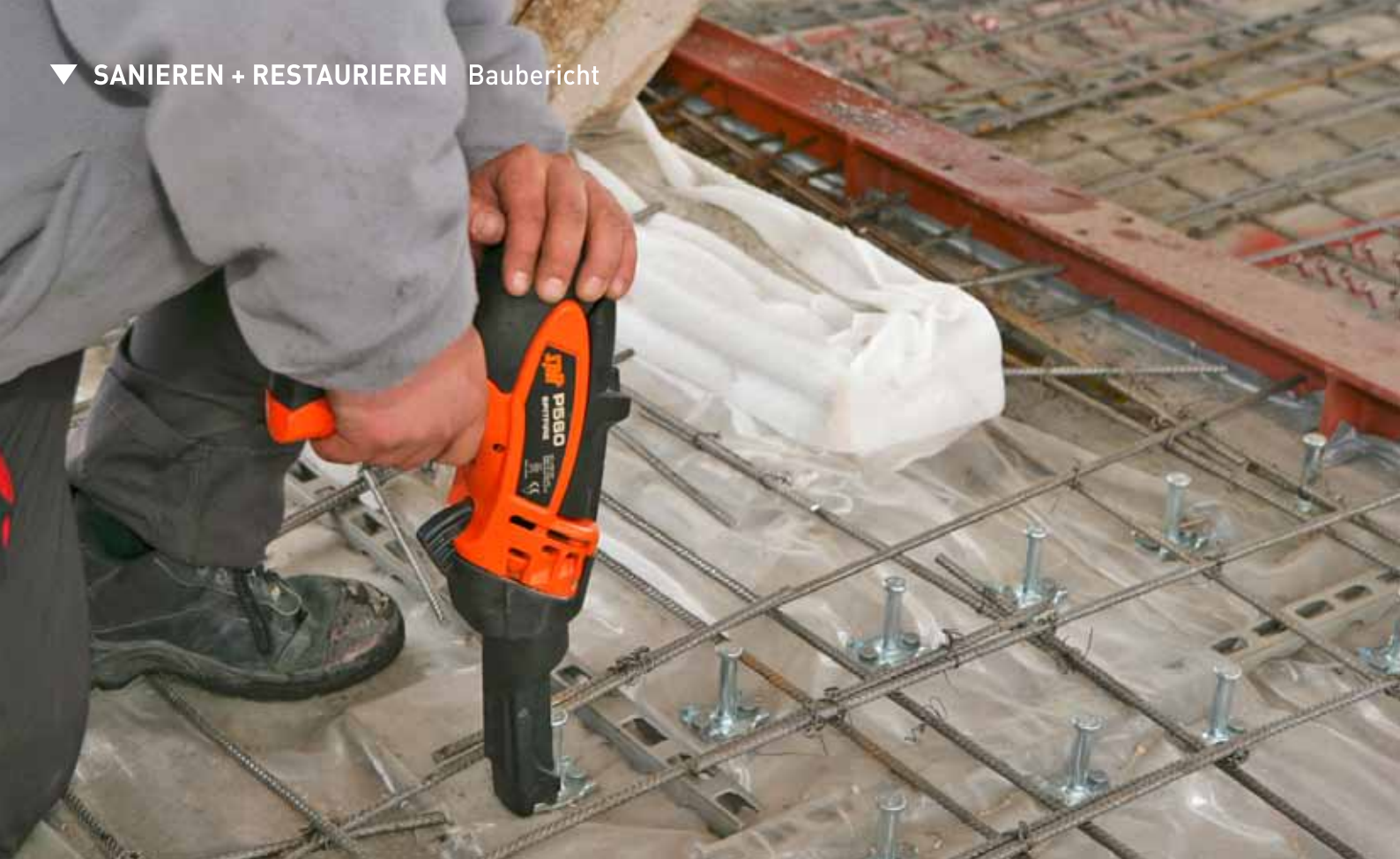
Beim Reibschweißen werden Nelsonkopfbolzen in Stahlträger eingeschossen, die unterhalb der künftigen Betondecke verlaufen Fotos: Prisma-Produktion, Staufen
