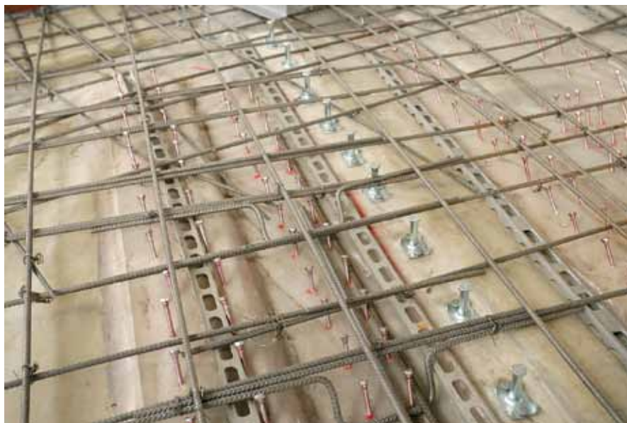
HBV-Standard-Decke als Plattenbalken; einseitig angeordneter Stahlträger zur Verstärkung mit Kopfbolzen in das HBV-System integriert; Trennfolie; zweireihige Anordnung SFix-3 in Richtung Auflager geneigt; zusätzlich U-förmige Zulagebügel; konstruktive Grundbewehrung
